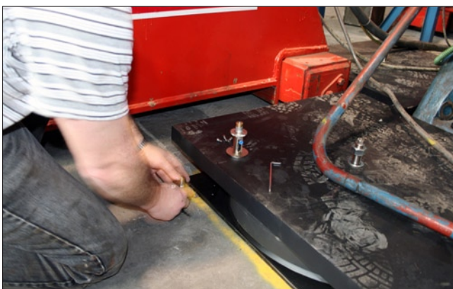
INSTALLATIE VAN HET AUTOMATISCH NIVEAUREGELINGSSYSTEEM.
