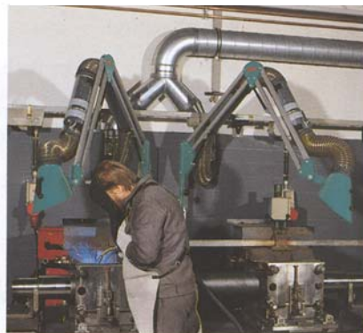
Rohrleitungsverzweigung mit 2 Absaugarmen
